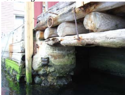
Bindhake i Sandviksboder 20. Nødreparasjon bolverk? Ukjent alder
