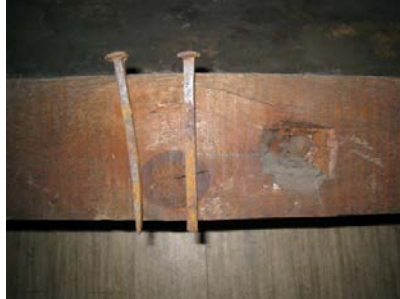
Klipt spiker fra takkonstruksjon Svensgården, 4B402.
